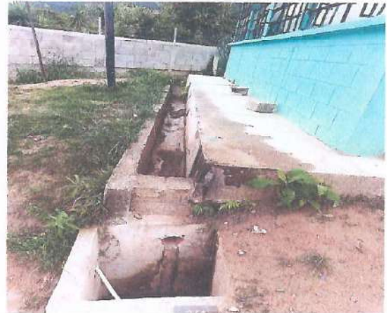
Foto 2: CUNETAS DESCUBIERTAS, PELIGRAN LA SEGURIDAD DE LOS PEQUEÑOS.
